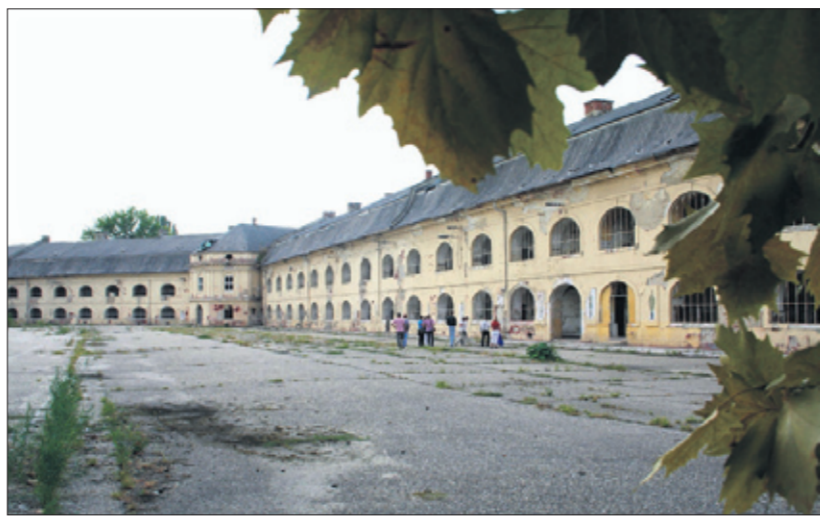
Fallande rappning, hål i taken, mögel och fuktskador är verklighet i fortets kaserner. Men likväl är byggnaderna viktiga minnesmärken. FOTO: KENNETH MYNTTI
